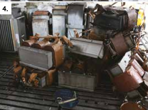
1. Transformadores de potencial
